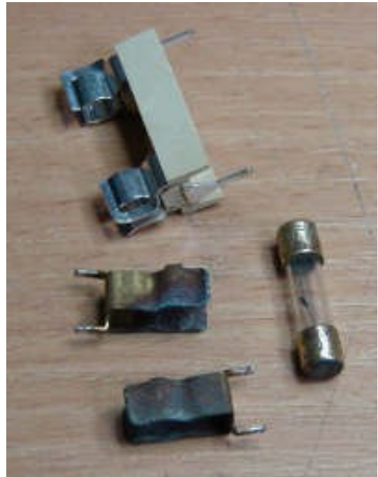
Bild 2: korrodierte Sockel und Ersatz
